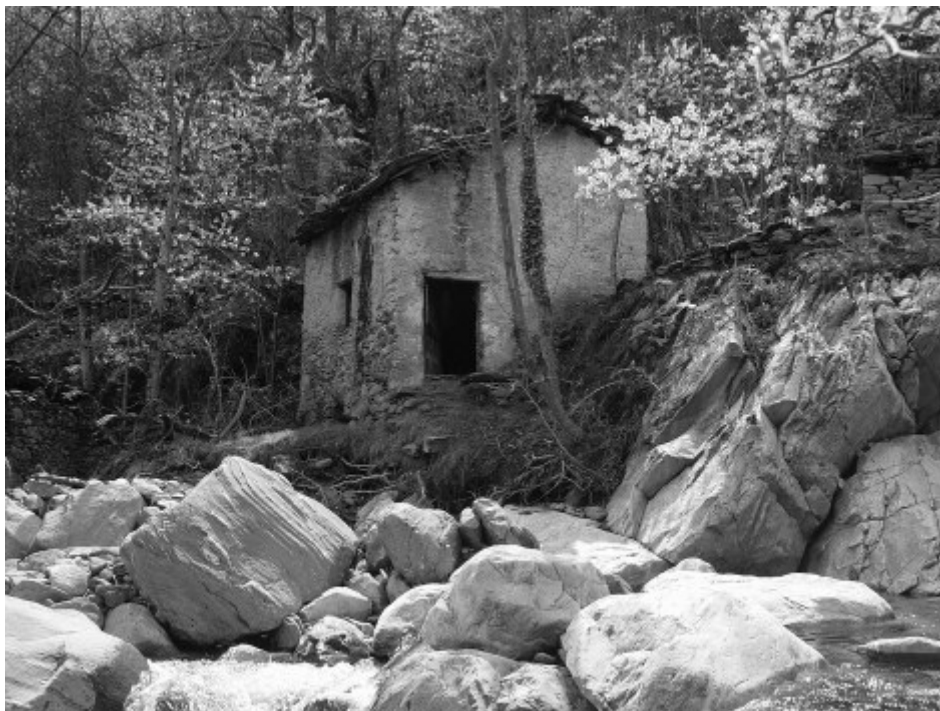
Fig. 26) Mulini Sibille-Charbon, a Chiomonte. Questo particolare opificio a ruota orizzontale è dotato di piano superiori, accessibile dal retro, con funzione di magazzino.
